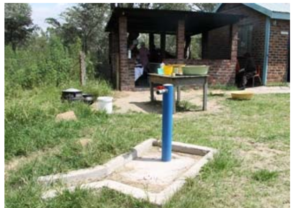
Den nye vandpost, som blot mangler tilslutning
