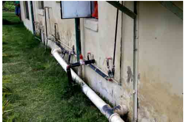
Nogle af de gamle bygninger trænger til et omfangsdræn, da vand i regntiden står op af soklen. Det er gammelt og dårligt byggeri
