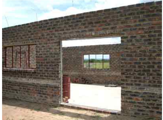
Denne bygning skal være det nye skolelokale. Vi har givet mursten og cement (Her blev slangen fundet..).
